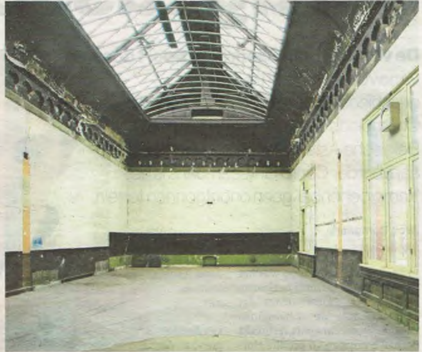
▲ De gestripte voormalige leeszaal. Door een ooit aangebracht verlaagd plafond is de fries helaas grotendeels kapot gemaakt.
